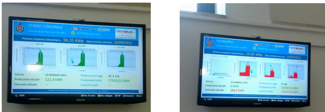
Figura 30: Monitor sulle prestazioni energetiche degli impianti fotovoltaici installati all'ingresso della sede comunale
